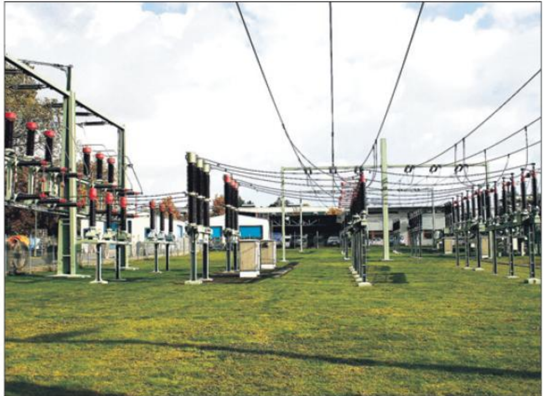
Achim, Oyten und Ottersberg suchen den energiepolitischen Schulterschluss. Unser Foto zeigt das Umspannwerk der EWE bei den Achimer Stadtwerken. • Foto: Brodt
